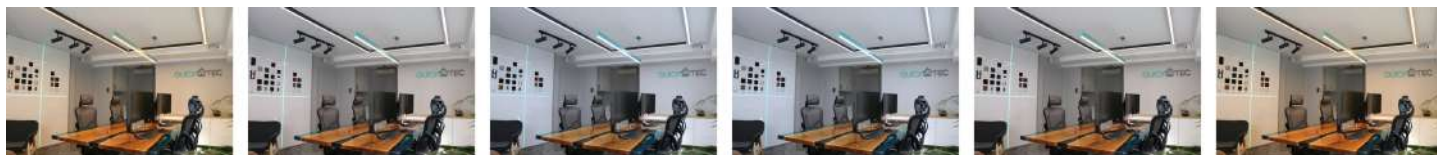
Przykład oświetlenia HCL zastosowany w siedzibie Firmy QuickTec.
